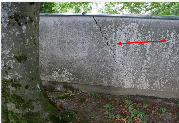
Abb. 8 Riss in der Grundstücksmauer
