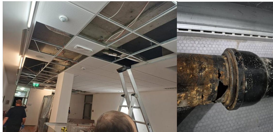
Wasserleitungsschaden in der Hauptfeuerwache
