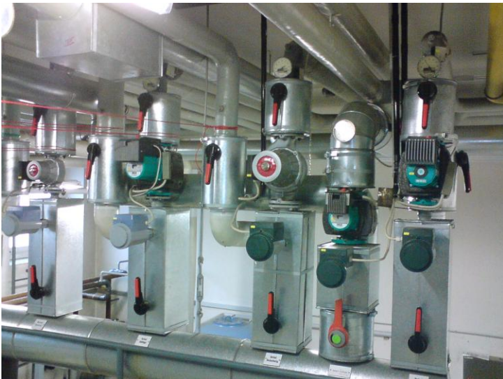
Heizungsverteilung Grund- und Mittelschule auf dem Lindenberg
