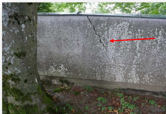
Abb. 8 Riss in der Grundstücksmauer
