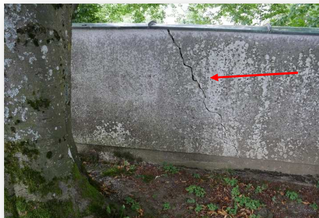
Abb. 8 Riss in der Grundstücksmauer
