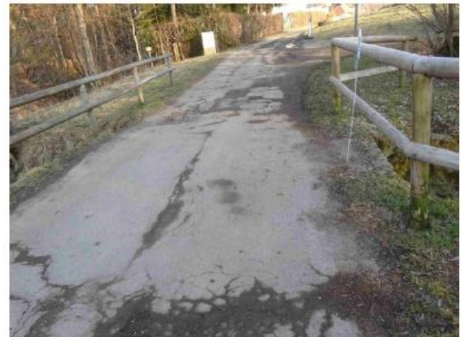
HP2022_BELAG GERISSEN UND AUSGEBROCHEN
