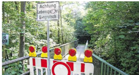
Am Illerradweg ist weiterhin eine Teilstrecke gesperrt. Auslöser war ein Hangrutsch im Frühjahr. Foto: Matthias Becker
