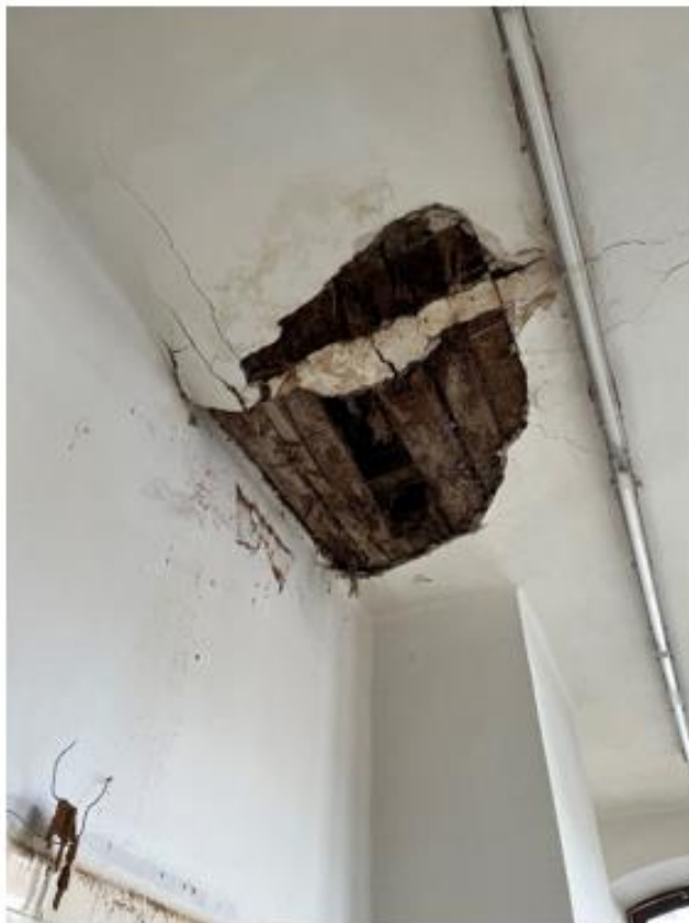
Deckendurchbruch im OG durch Feuchtigkeit im Dach
