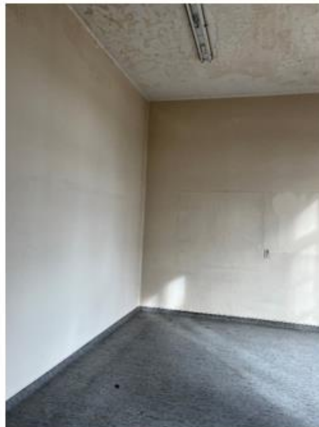
Feuchte Decken im OG
