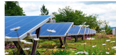
PV-Anlage mit extensive Dachbegrünung
