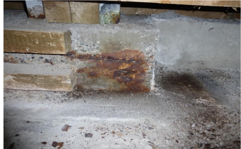
Starker Chlorideintrag bei den Stahlbetonfundamenten
