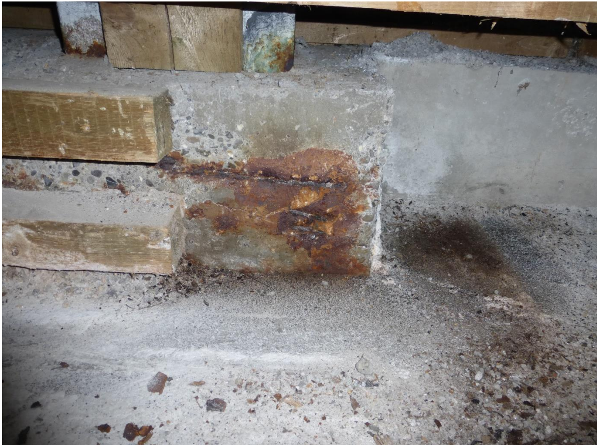
Starker Chlorideintrag bei den Stahlbetonfundamenten
