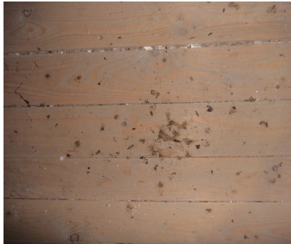
Abb. 3: Fledermauskot im Dachboden (Westseite).
