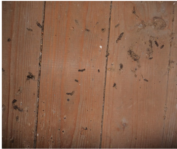
Abb. 2: Fledermauskot im Dachboden (Ostseite).
